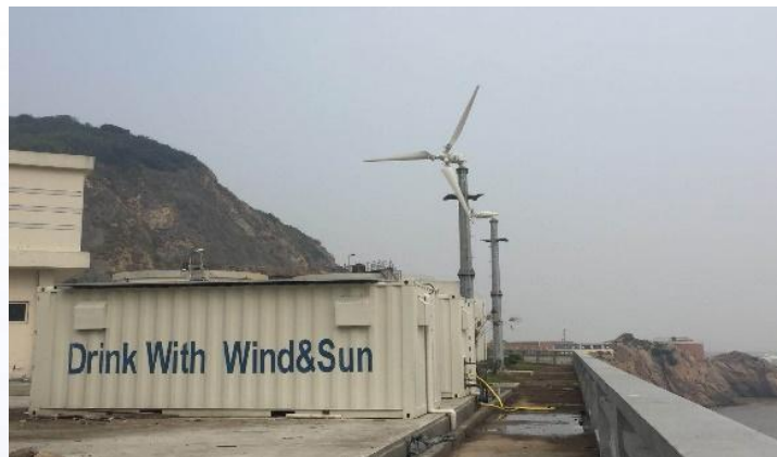
嵊泗列岛风力储能系统
